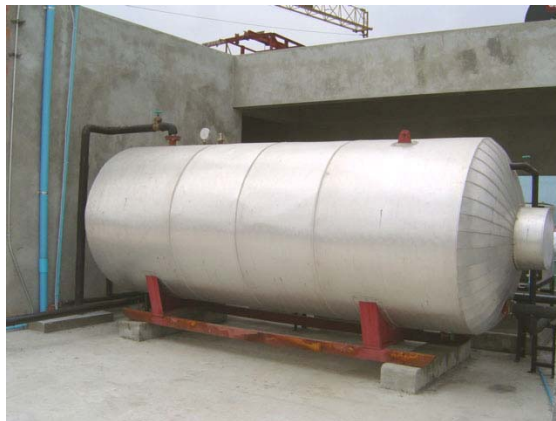
รูปที่ 5 แสดงถังเก็บน้ำร้อนของระบบ
